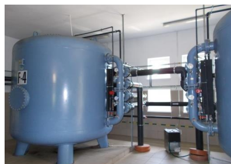
Stacja Uzdatniania Wody Książki
